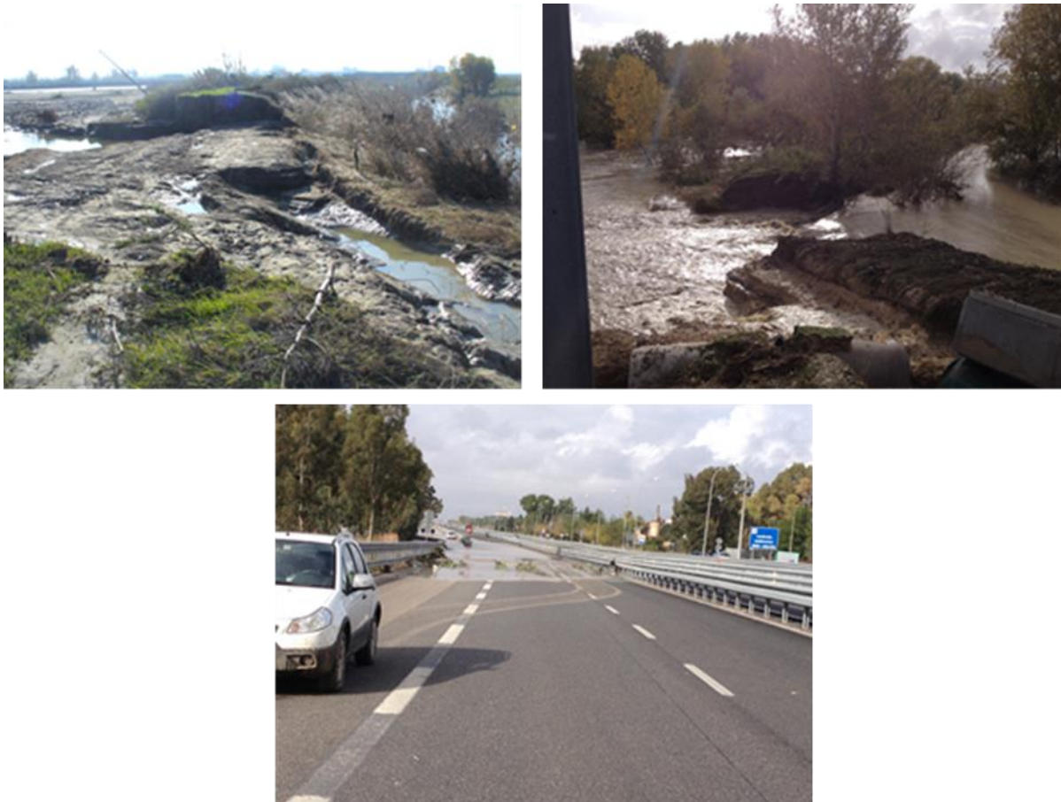
Figura 1.18 - Vista della rottura arginale lungo il T. Cervaro con interessamento della SS16
